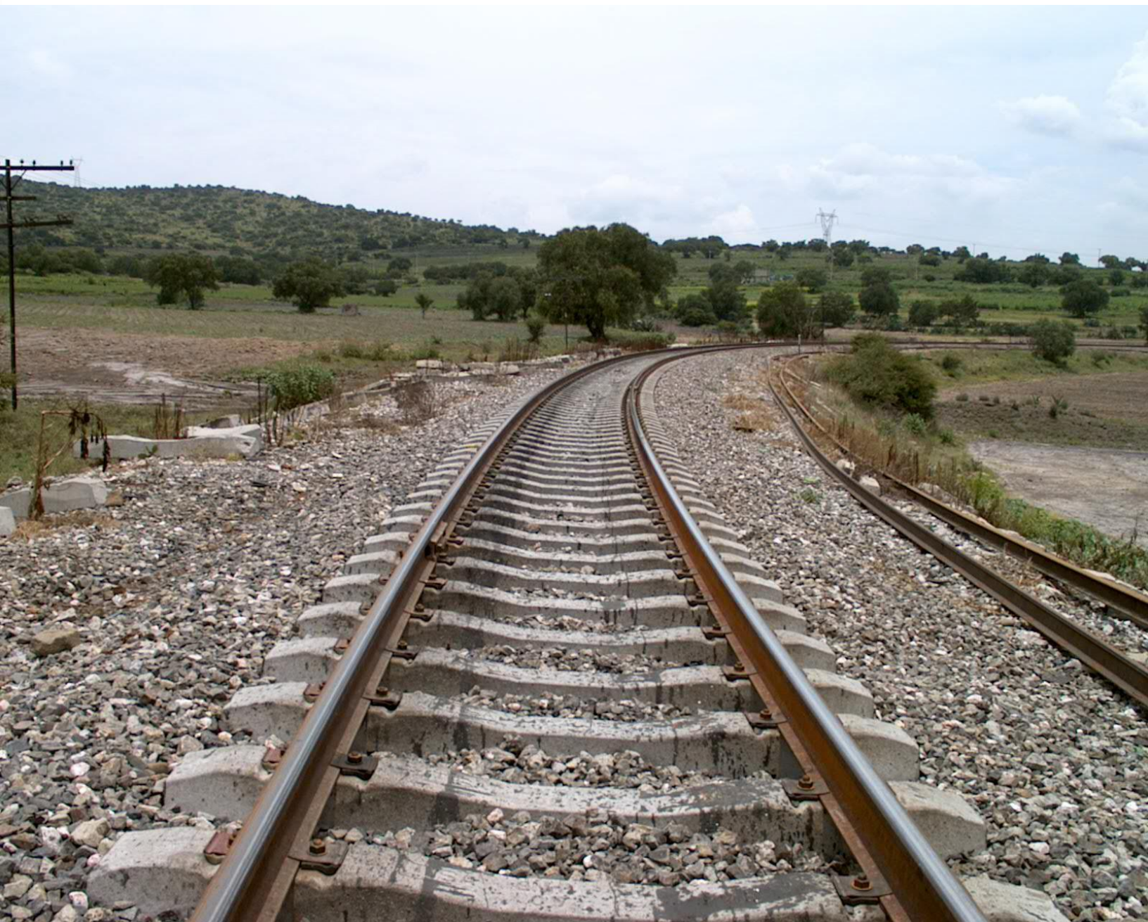
Curva derecha de 5°. Instalación de sistema de fijación elástica NY-GN en Km B59 [01-Mar-05].
